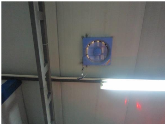
图 6-3 X 光检测室内机械通风装置
