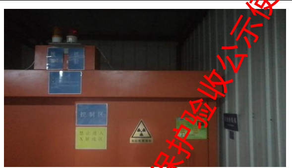
图 6-2 专用铅房电离辐射警告标志、警示灯
