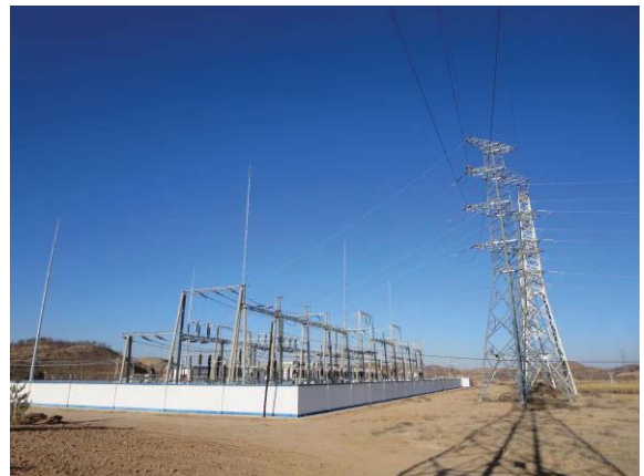
1 号塔基及米脂东山梁 110kV 变电站
