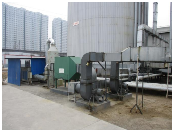
项目在用沥青废气处理设施
