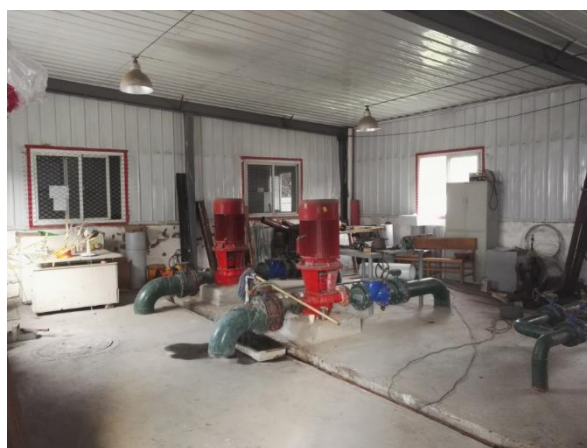
项目消防水泵
