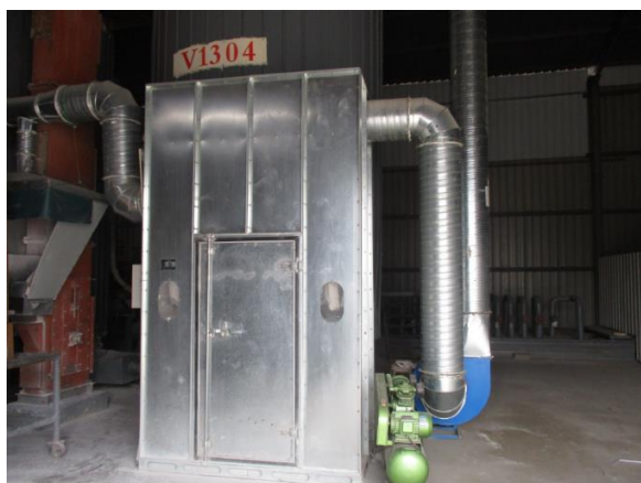
项目投料粉尘袋式除尘器
