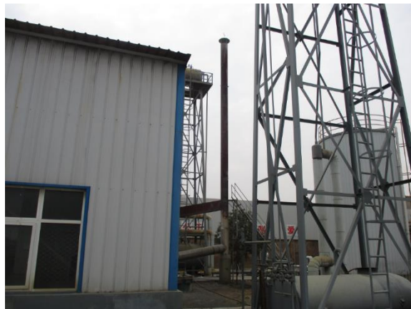
项目导热油炉烟气排气筒
