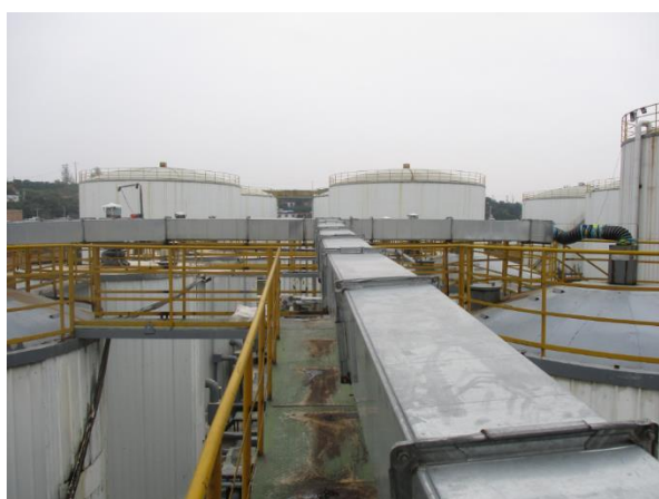
项目沥青生产废气收集管道
