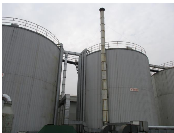
项目沥青生产废气排气筒
