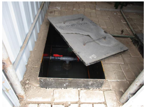
项目地理式一体化处理设施
