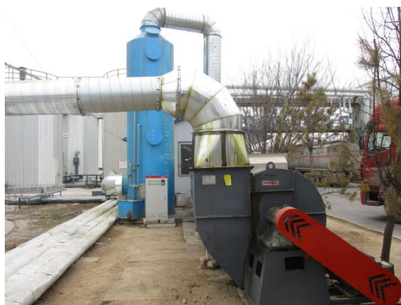
项目备用沥青废气处理设施
