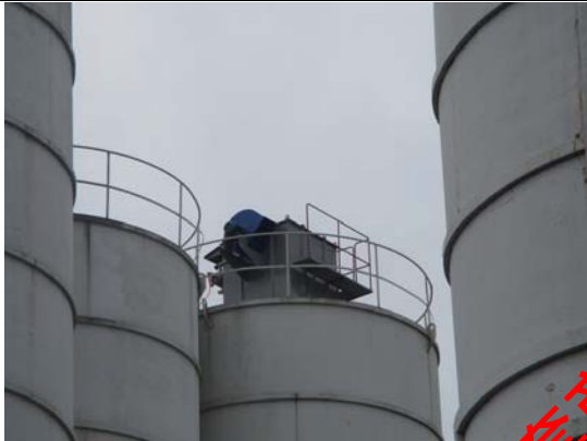
筒仓顶部 MCCQ25F 型脉冲除尘器
