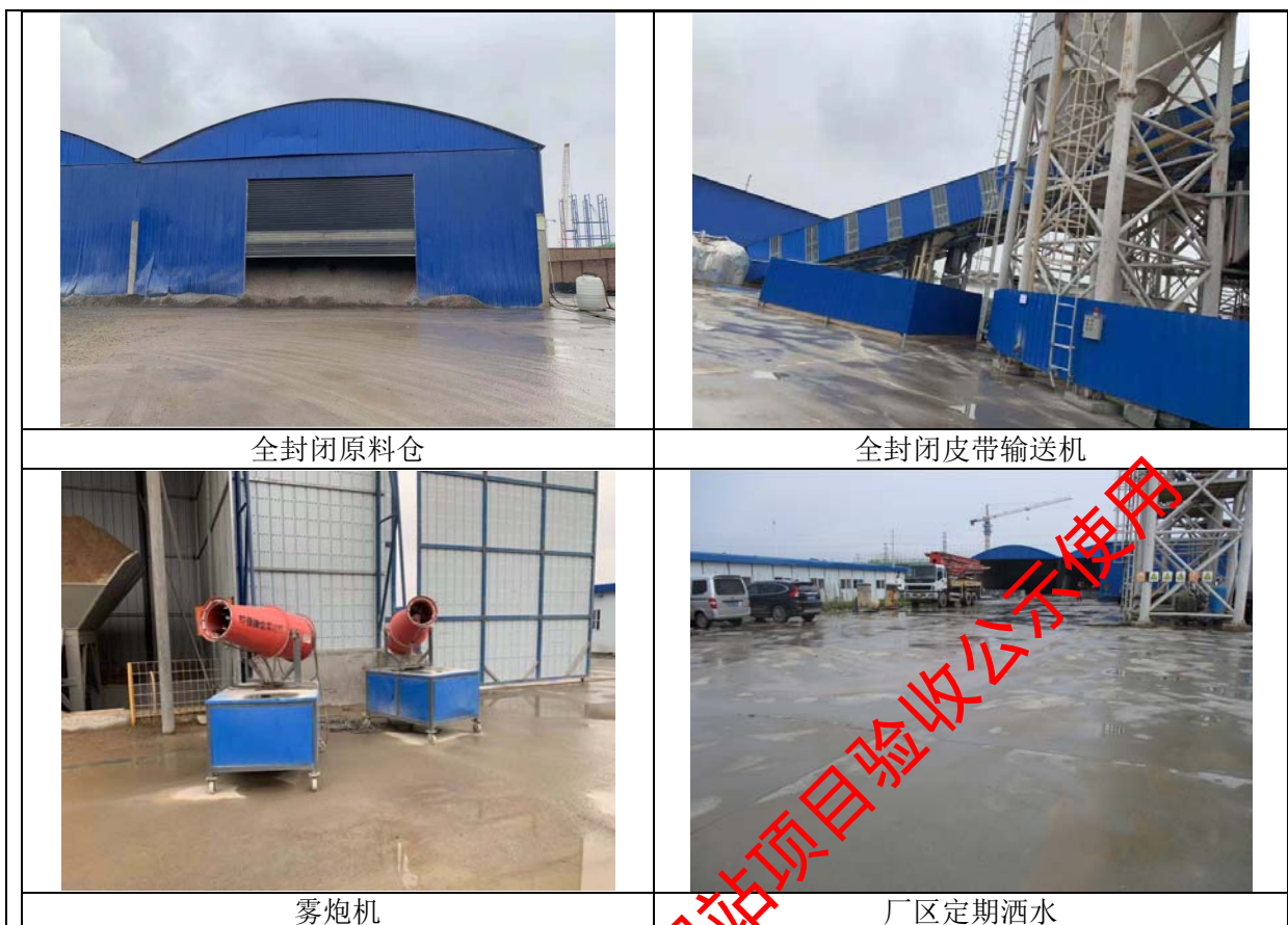
图 3-1 废气治理设施现场照片
