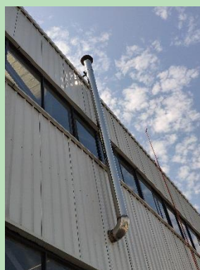
加热炉排气筒
