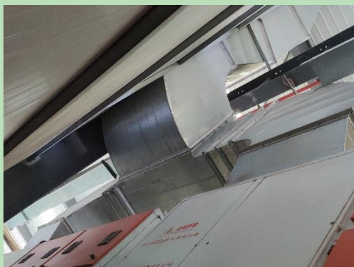
排气筒（喷漆、烘干汇合处）
