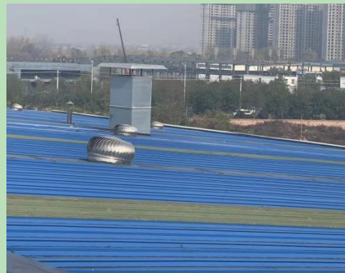
喷漆烘干排气筒（外部）
