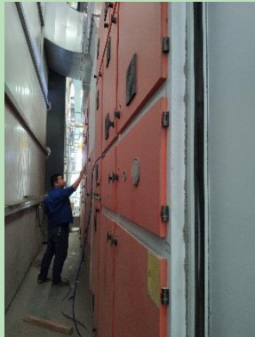
废气处理设施（内嵌式）
