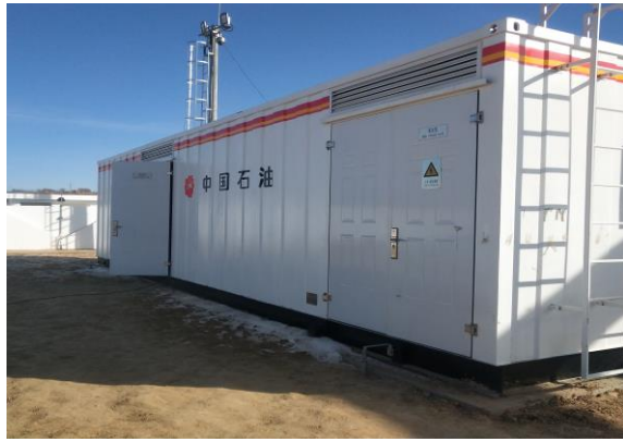
项目配电设施
