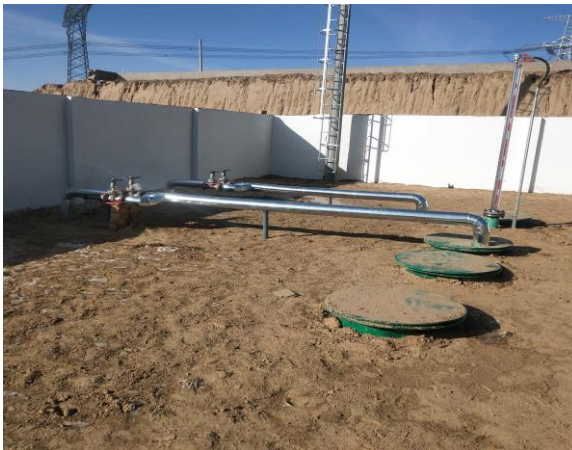
地埋式污水罐
