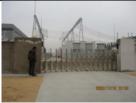
沙井 330kV 变电站大门
