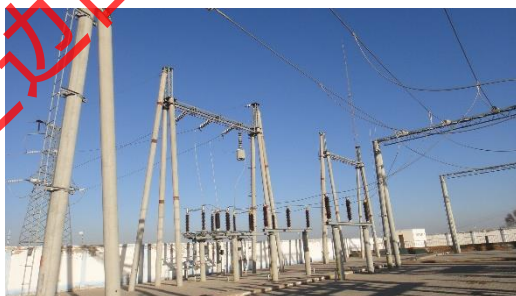
现有主变间隔
