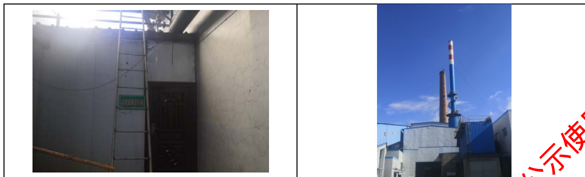
图 3-6 烟气在线监测系统现场照片
