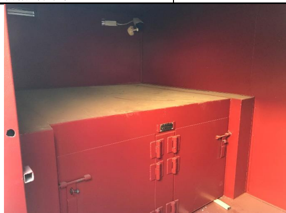
测井中子源罐储仓
